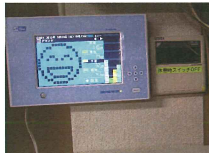
東京 デマンド監視
