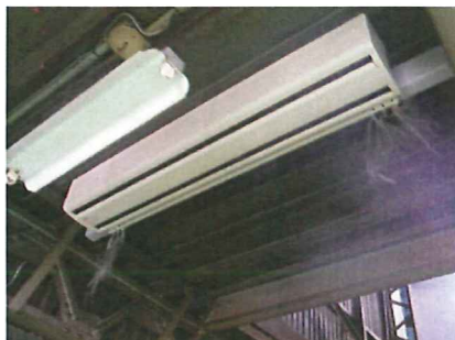
東京工場 エアカーテンで断熱2F
